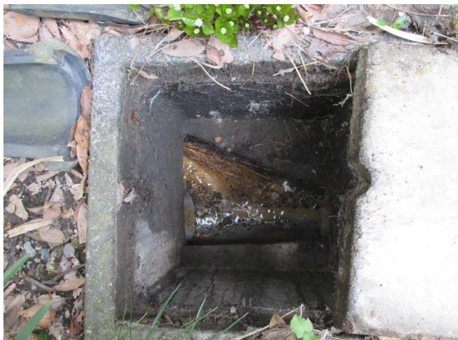
汚水配管に根が入り、汚物を詰まらせています。
